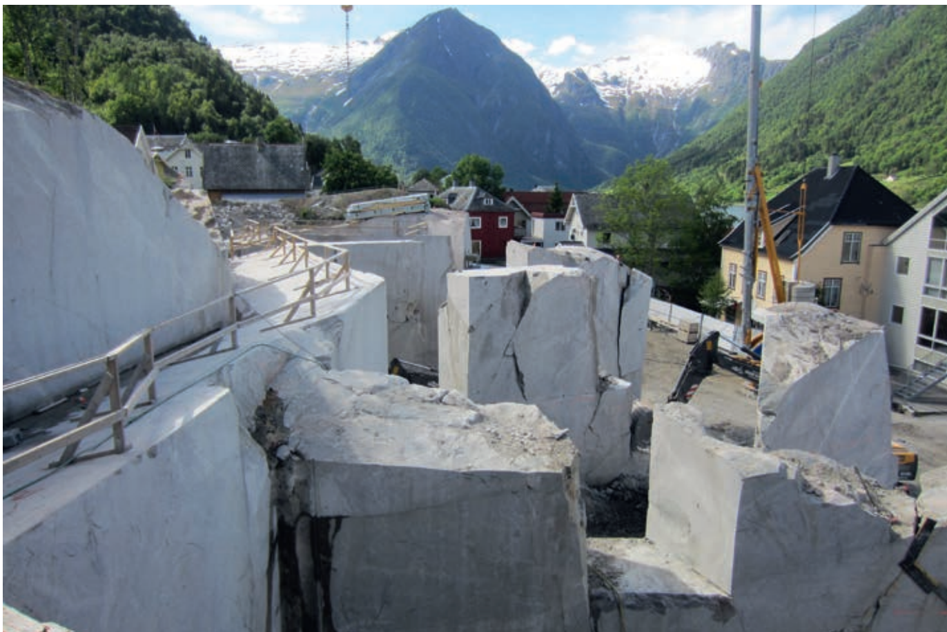
Motstående side: Reiselivsmuseet er skåret inn i en fjellknaus i sentrum av Balestrand. Over: Fra byggeplassen. Fjellskivene som står igjen er bærekonstruksjonen i museet. Facing page: The museum is cut into an outcrop of rock in the centre of Balestrand. Above: During construction. The rock pillars form the main loadbearing structure.
